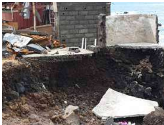
Une maison détruite au sud de l'île de Ngazidja par des grosses vagues engendrées par le passage du cyclone
