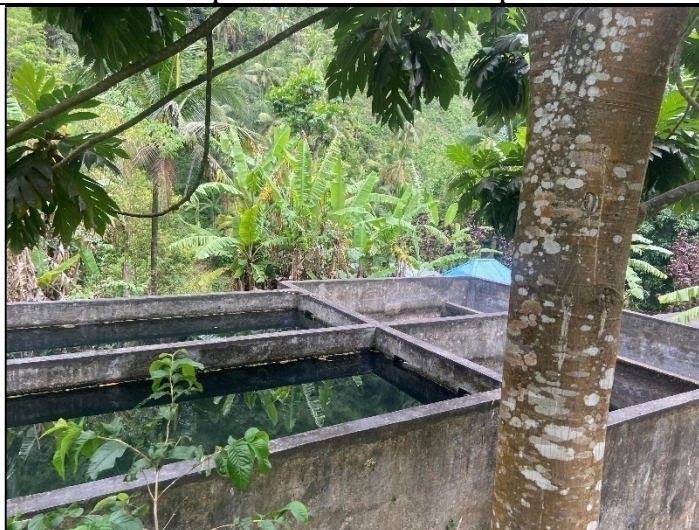
Figure 9 : filtre à sable à Mohéli
